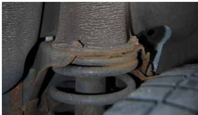
Foto 1: Chassis rust via steun op veerschotel.
