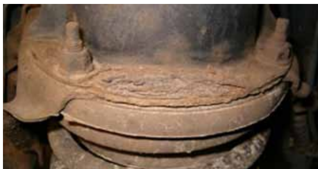
Foto 2: Schokdemperbevestiging aangestast door roest.
